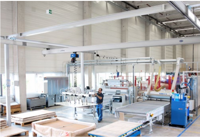
Aluminium-Einträgerkrananlage mit Vakuum-Hebegerät VacuMaster Comfort bei der Maschinenentladung
