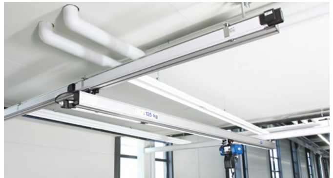
Krananlage mit Schleifleitung zur Versorgung eines Kettenzugs
