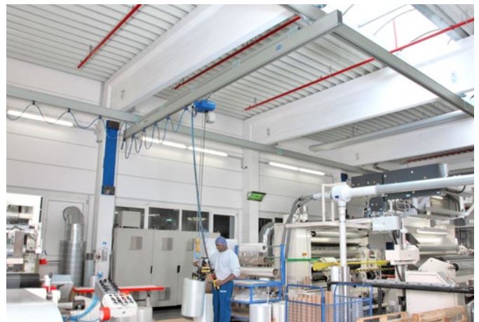
Aluminium-Mehrträgerkrananlage mit Verstärkungsprofil und Kettenzug bei der Handhabung von Folienrollen
