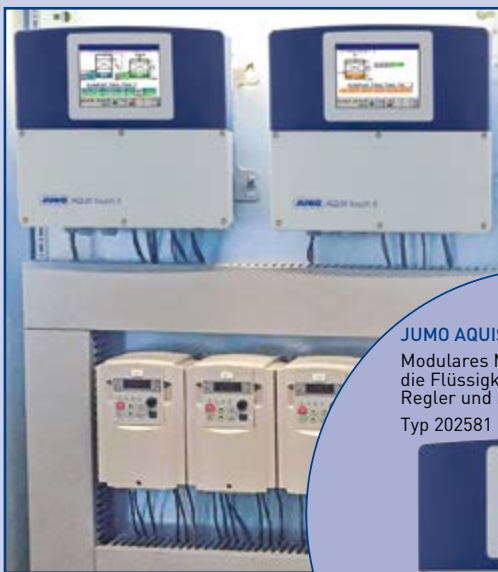
Einbausituation im Schaltschrank
