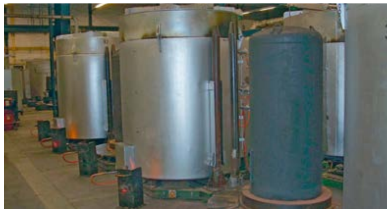
Haubenofen, im Vordergrund noch ohne Heizhaube, im Hintergrund mit aufgesetzter Heizhaube
