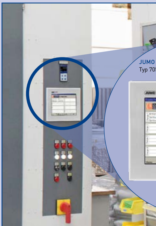
Einbausituation am Temperofen
